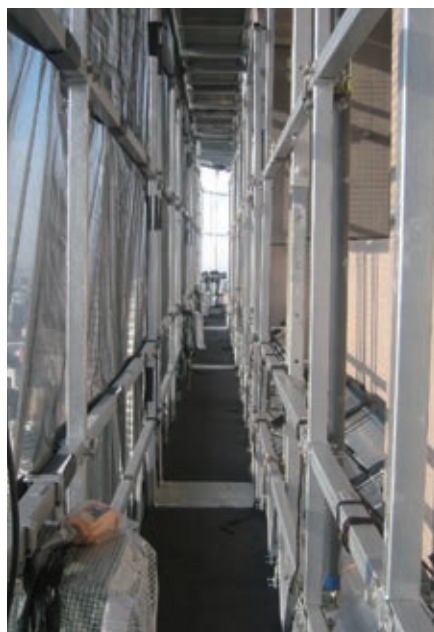
▲ ゴンドラ内部
